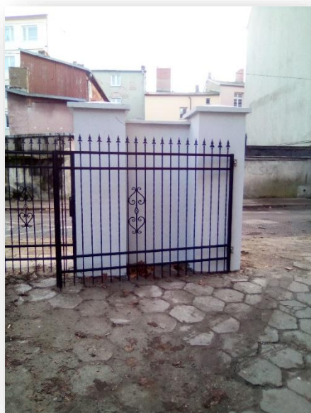
Budowa nowego ogrodzenia na terenie działki nr 588 od strony ul. Murarskiej w Słupsku (zaplecze nieruchomości ul. Sienkiewicza 20)
